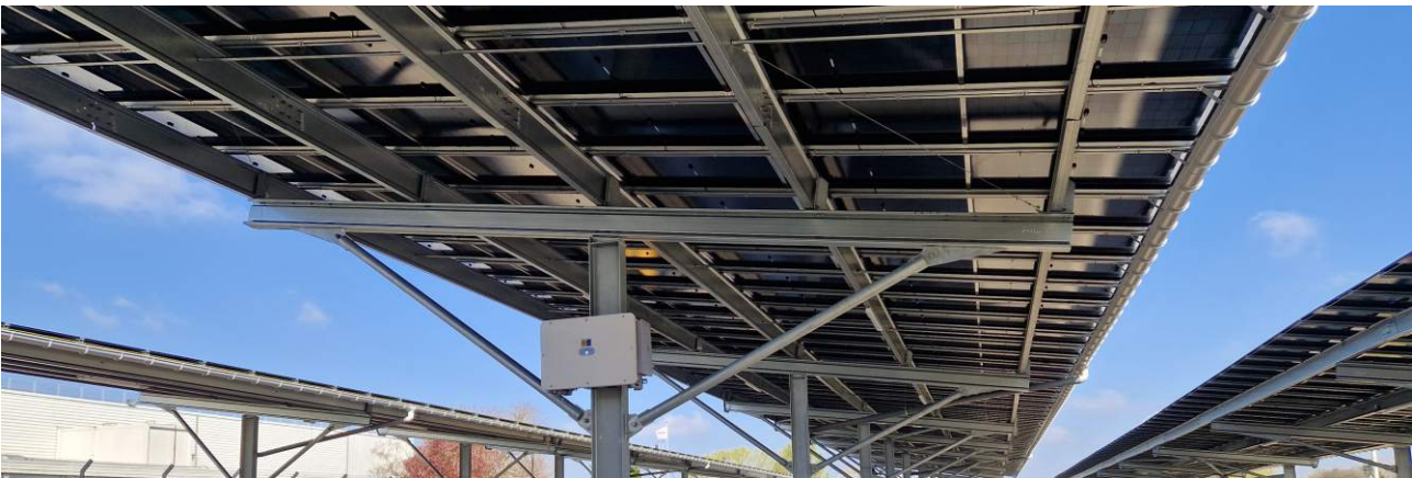
Carporturi fotovoltaice - Franța
