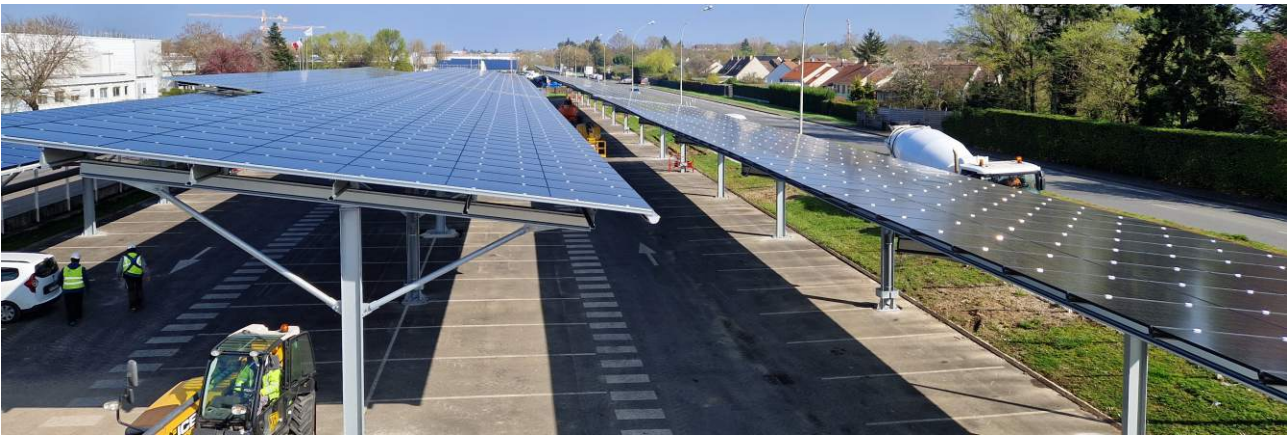
Carporturi fotovoltaice - Franța
